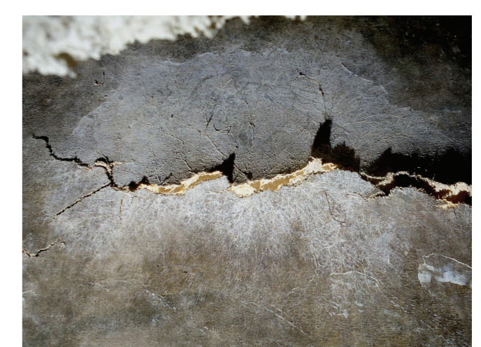
oben: Sicherung wegen des Risses 2009
